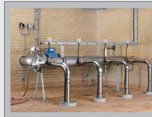
Из подземного водохранилища насосами вода перекачивается на поверхность
