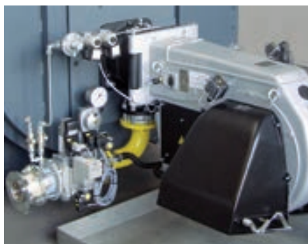
Горелка ELCO выполненная в едином дизайне Viessmann на Vitomax 100-LW
