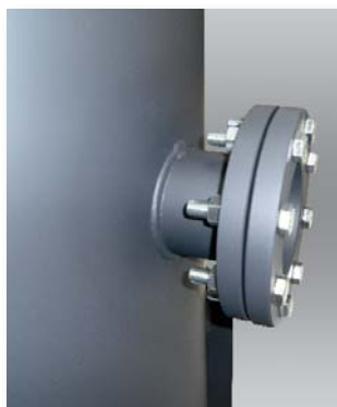
■ Переливной сброс воды в систему водоотведения
